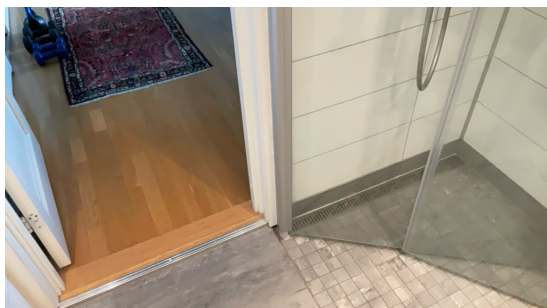
Dør plassert i dusjen fuktsone.
