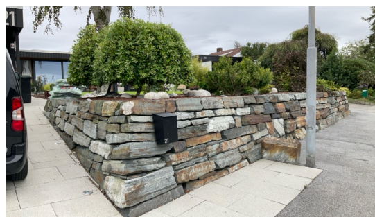
Forstøttningsmur framside uten fallsikring.
