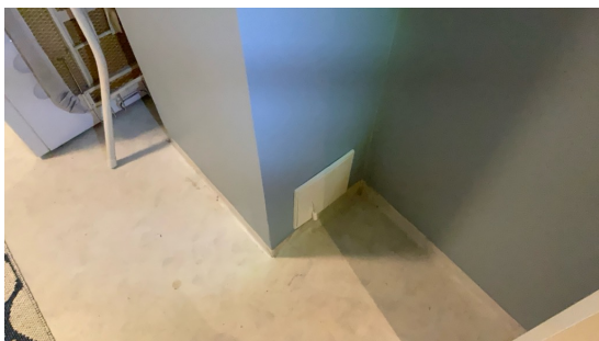
Luke med stengekran på vann.
