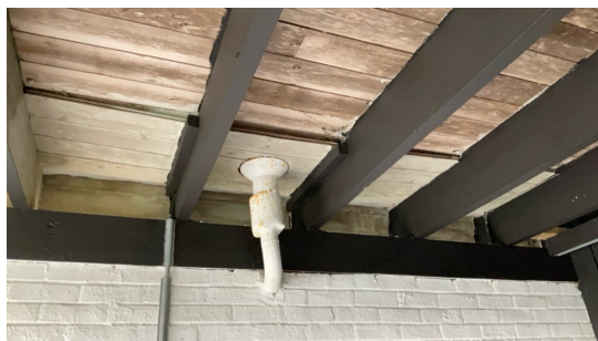
Det har nylig vært lekkasje fra området omkring sluk sett i garasje.
