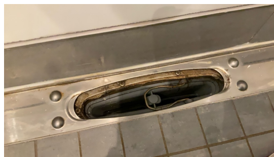
Slukrenne i dusj.
