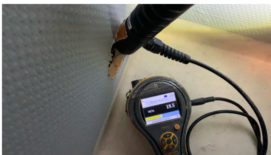
Fuktsøkt i påforet yttervegg i tre i risikosone/gult.
