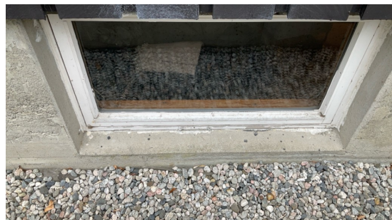
Vinduer i kjeller med malingsavflassing på overflater.
