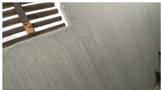
Sprekk i mur ved kjellertrapp.
