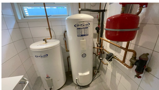
Varmtvannsbereder på 198 og 300 liter med stoppekrane fra 2005 og 2007.
