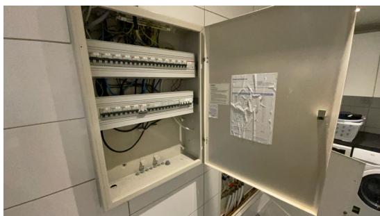
Automatsikringer U et, i el skap alder ukjent.
