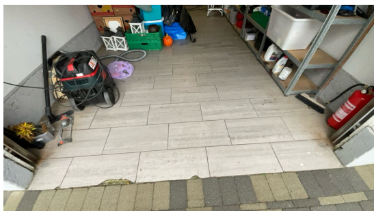
Det er sprekker i enkelte fliser og bom/løse fliser på gulv.
