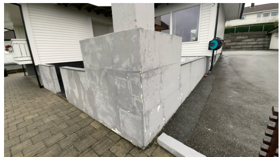
Det er sprekk i mur/peis.
