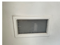
Krakelering rundt vindu på hoveddør.
