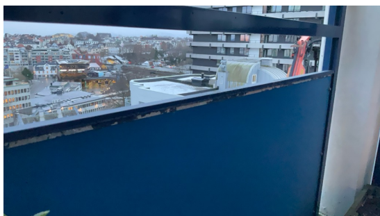
Åpninger over 10 cm i rekkverket.
