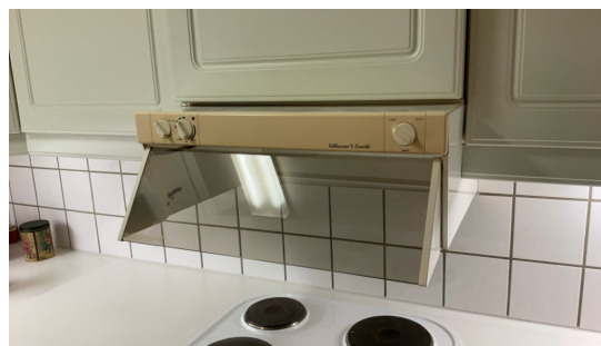
Ventilator/motor for ventilasjonsanlegget.
