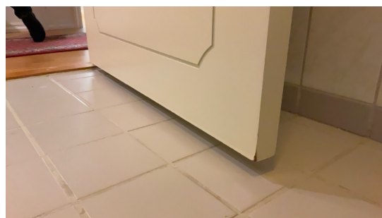
Fuktskader/svelling i nedre kant dørblad til bad.
