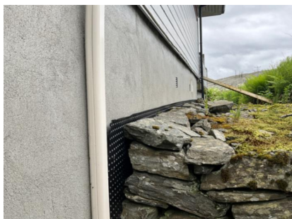
Det er ikke montert topplist/ innpusset i grunnmur
