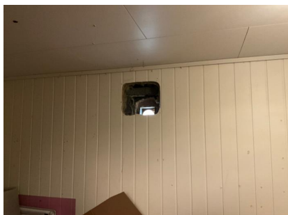
Stort hull gjennom yttervegg.
