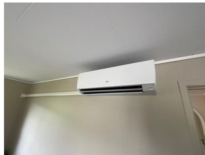
Varmepumpe i stue.
