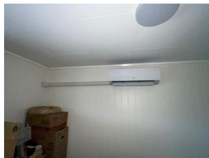
Varmepumpe på kjøkken i underetasje.
