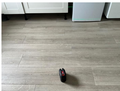
Kjøkken: ca. 20 mm. høydeforskjell målt over 1,27 meter (laveste punkt ved skap)
