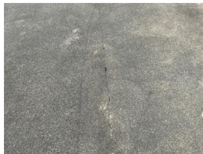
Sprekk i terrasedekke over carport.
