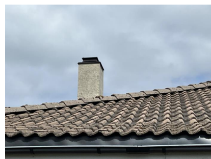
Pusset pipe over tak. Sprekker i puss/ pipeløp.
