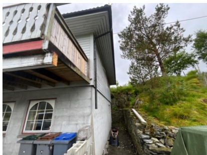
Nedløp, gavlvegg nord, er avsluttet ca. 1,75 meter over bakkenivå.
