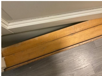
Dør til bad tar i dørterskel.
