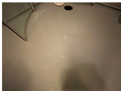
Skrapemerker på gulv.
