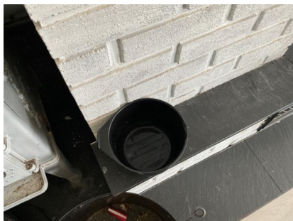
Lekkasje rundt pipe.
