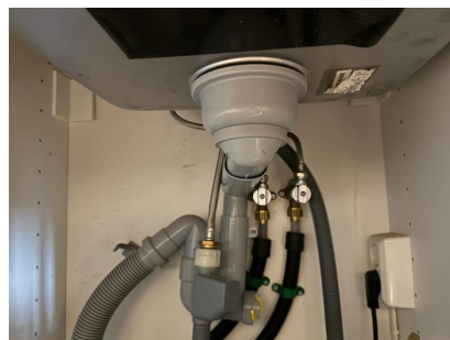
Rørøpplagg under kjøkkenvask i underetasje.
