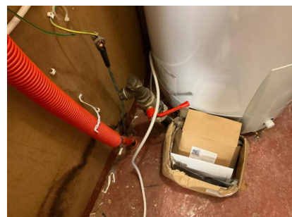
Røropplegg/ stoppekran da brønn ble benyttet.
