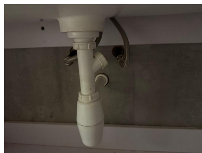
Rørøpplagg under håndvask, bad, underetasje
