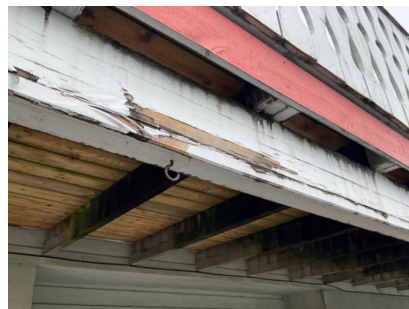
Drager (bæring til alran mangler vedlikehold).
