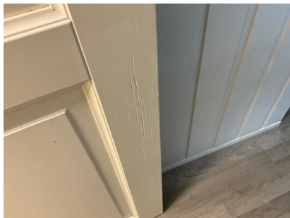
Skrapermerker på dør i underetasje (dør mellom ganger ved bad).
