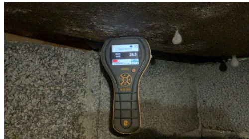
Fuktmåling i underkledd vindtettplate vest med måleresultat på 26,3 %
