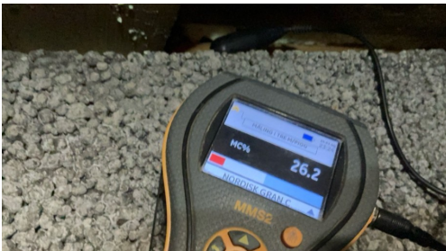
Fuktmåling i svill i krypkjeller vest med måleresultat på 26,2 %
