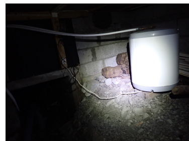
Varmtvannstank, opplagring under tanken
