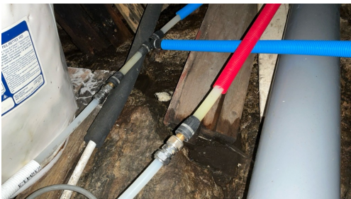
Vannpytter på fjell i krypkjeller sørøst
