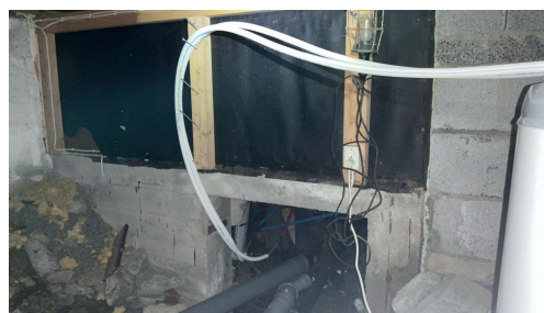
Rør i krypkjeller til varmtvannstank
