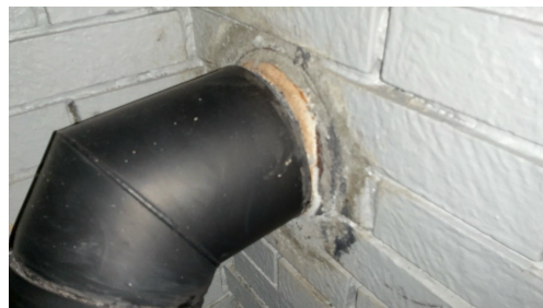
Røykrør inn i pipe
