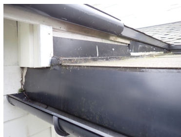
Overgang beslag - bordkledning på tak over kjøkken
