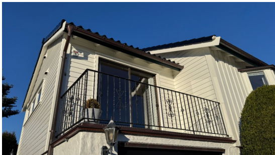
Rekkverkshøyde i tråd med krav i tilbyggsår.
