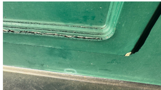
Delaminering av brystningspanel/entredør.
