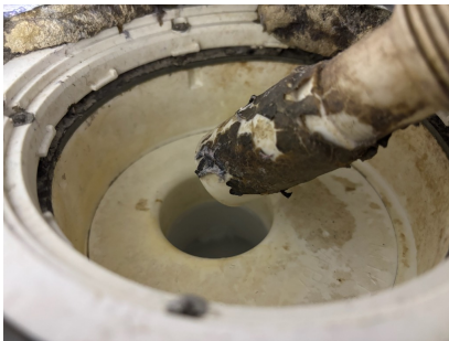
Sluk under dusjkabinett.
