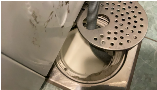
Sluk i gulv.
