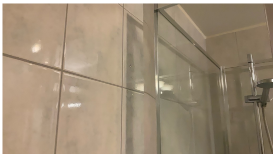
Borrede hull i veggfliser.
