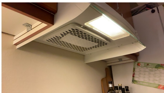
Ventilator funksjonstestet med papir.
