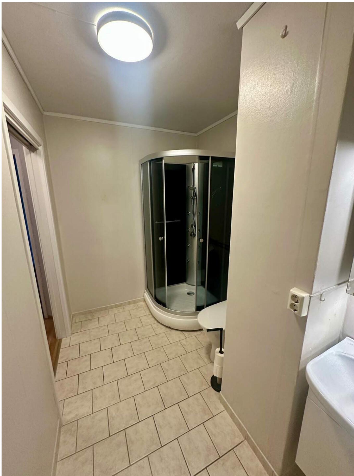
Her er det installert et moderne dusjkabinett.
