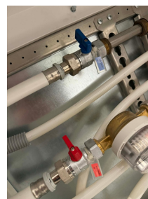
Stoppekraner for varmt/kaldt vann i fordelerskap.
