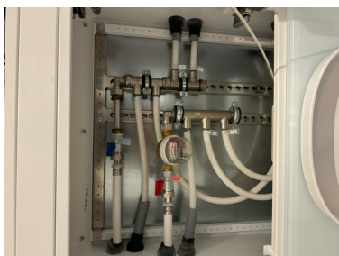
Fordelerskapet er plassert over vegghengt toalett på bad/vaskerom.
