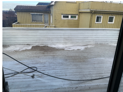
Terrassebord ligger tett, noe som hindrer vann i å renne av.
