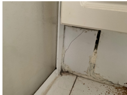
Sprukket flis, har blitt utbedret med fugemasse på et tidspunkt.
