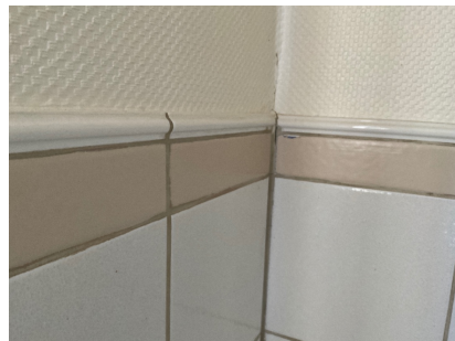
Sprekker i fuger i hjørner.
