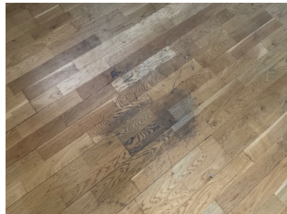
Skade på gulv i stue
