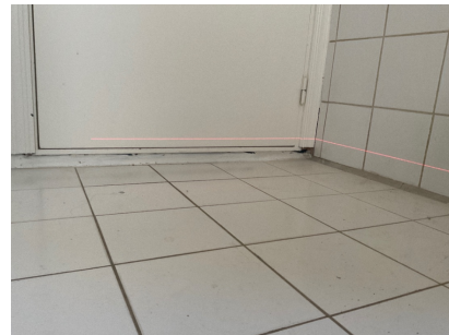
Motfall mot dør, synlig oppbrett
