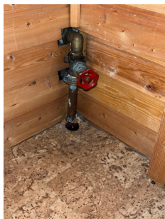
Hovedstoppekran er plassert inne i bod på siden av vaskerom. Noe irring på koplinger.
