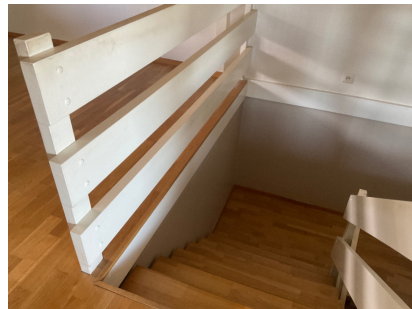
Manglende håndrekke på vegg.
