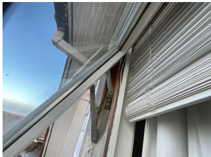
Pakninger er harde og løsner. Tegn til innvendige kondenseringer.
