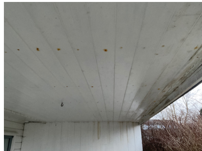
Festemiddel har rustet
