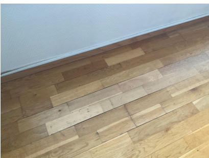
Vannskade parkett stue
