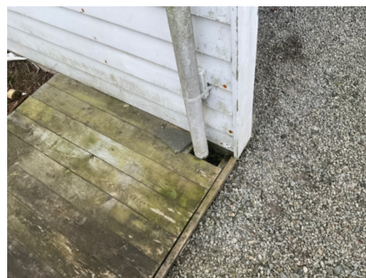
Nedløp fra terrassen er avsluttet over terreng
