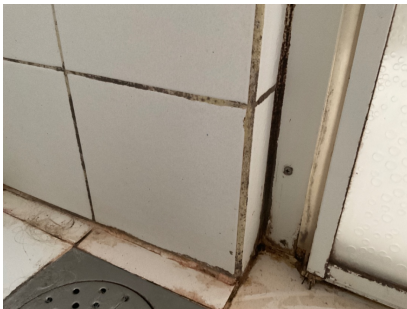
Svertesopp i fuger.
