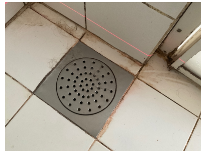
Slitte fuger i dusjsonen
