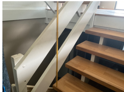
Rekkverk under 90cm med store åpninger i bunn.
