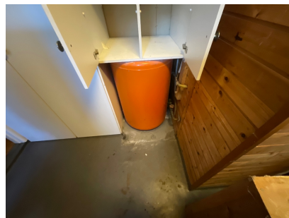
Eldre bereder plassert inne i innredningen.
