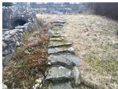
Manglende håndrekk til trapp, steinflater har mosegroing.
