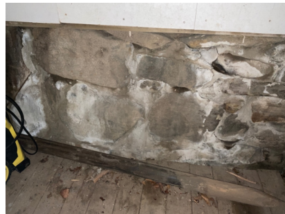
Sprekker i støttemur i utvendig bod.
