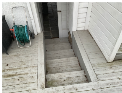
Manglende rekkverk på deler av trappen.
