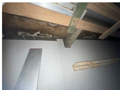
Det er fuktskader i sponplater under takterrasse
