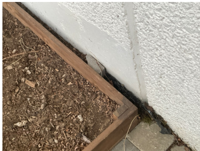
Manglende topplist. Grunnmurs plast avsluttet under terreng.
