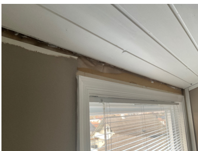
Manglende list og tapet.
