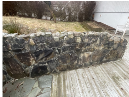
Sprekker i støttemur.
