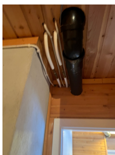
Vannledninger av kobber med plastkappe.
