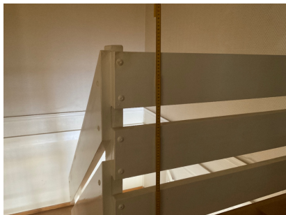
Rekkverk under 70cm, rekkverk oppfordrer til klatring
