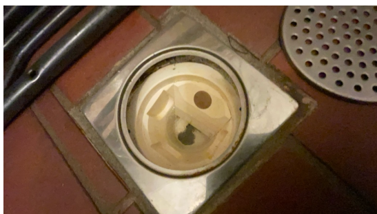
Sluk i gulv, uten synlig membran.
