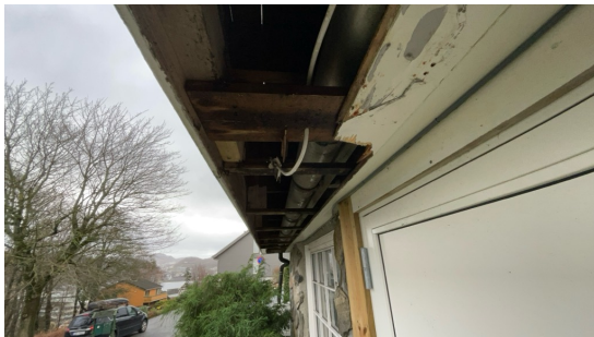
Fuktskader og delvis revet kledning under kasse mellom terrasse og dør til utvendig bod.
