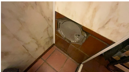
Det er mindre enn 300mm fra feieluke til brennbare plater i bad i underetasje.
