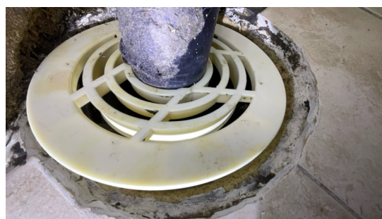
Sluk i gulv.
