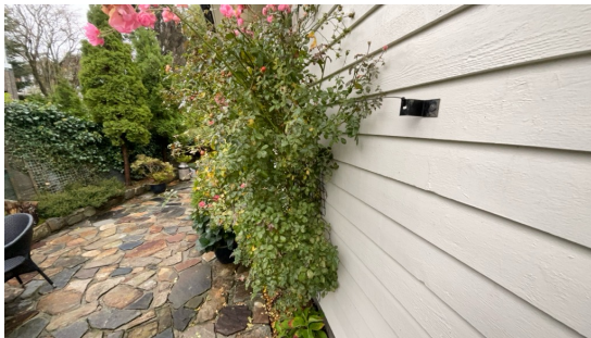
Vegetasjon vokser opp inntil kledning.
