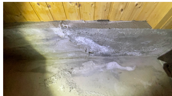
Salt/kalkutslag på grunnmur hvor denne er synlig.
