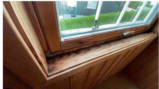
Fuktmerker i karm til vindu i soverom på loft.
