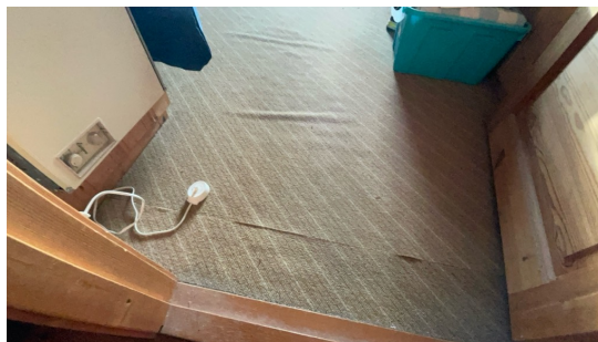
Bølger og gliper i skjøt på teppe i soverom.
