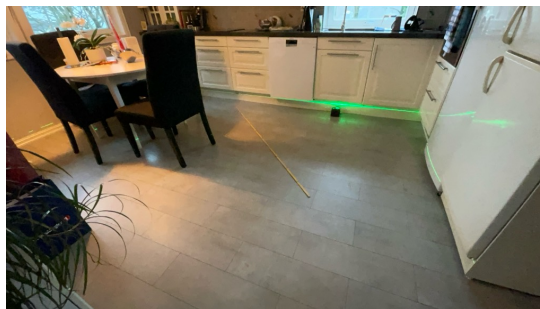
Retningsavvik på gulv i kjøkken.
