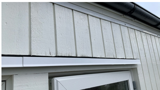
Oppsprikking/avflassing på nedre del av bordkledningen over vinduer/dør.
