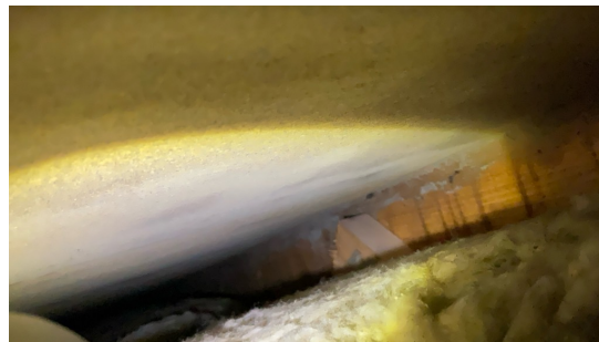
Merker etter kondensering/svertesopp på undertak/sutak.
