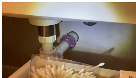
Ikke fuktrettet rørgjennomføring i vegg under vask.
