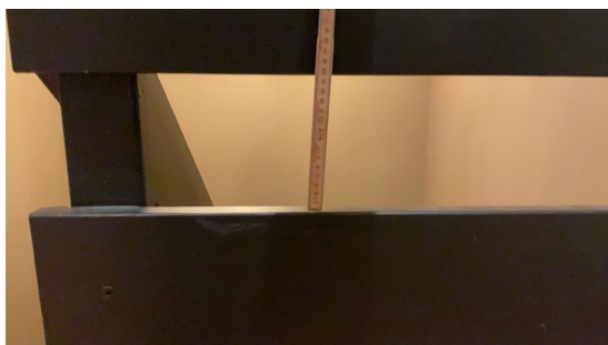
Større åpninger i rekkverket.
