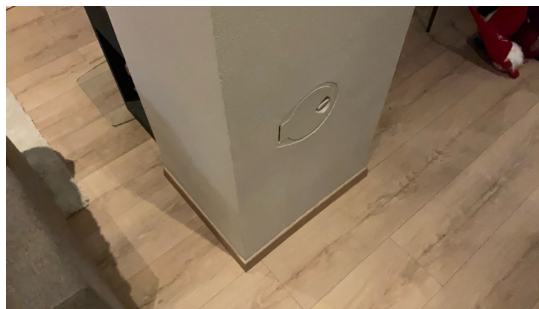
Feieluke, mangler ubrennbar plate på gulv under.
