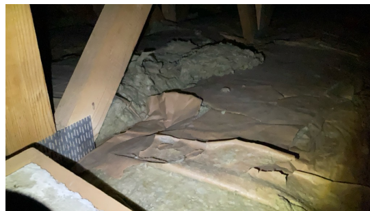
Isolasjon som ligger i uorden/mangler av papir på kald side.
