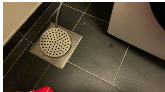
Bl.a område på gulv med bom/hullyd under fliser.
