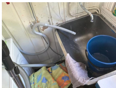
Synlige symptomer på høy belastning av fukt.
