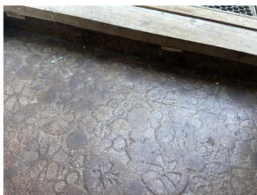
Sprekk i vinylbelegg.
