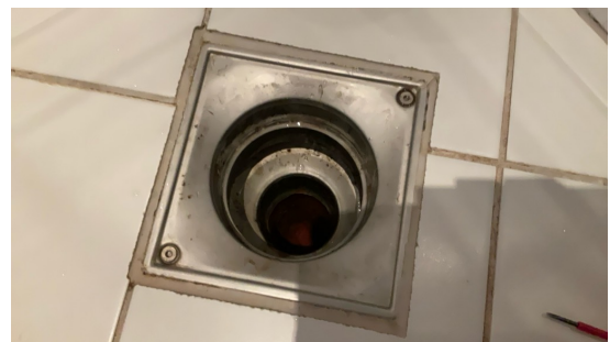
Sluk i gulv.
