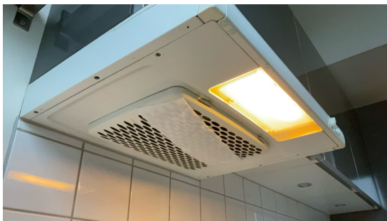
Ventilator testet med papir.
