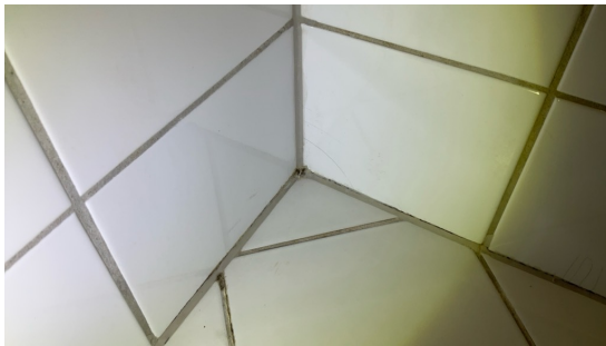
Sprikk i veggflis i dusj.
