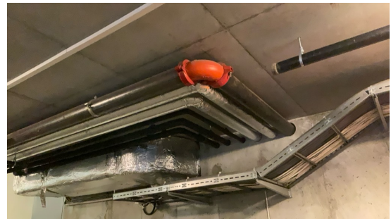
Synlig avløpsrør i plast/PVC, her på fellesanlegg/område.
