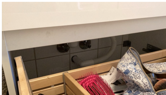
Åpent rundt gjennomføring i våtzone
