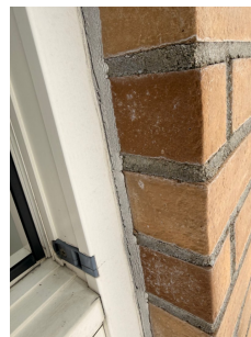
Tetting rundt vinduer mot fasade er oppsprukket.
