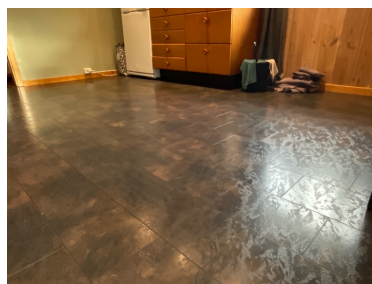
4 mm skjevhet på kjøkken. Innenfor normalen.
