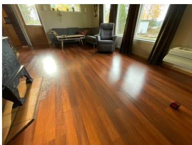
Kontrollert område i stue, uten avvik, Registrert 2 mm høydeforskjell.
