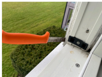
Råte i listverk på vindu i kjøkken.
