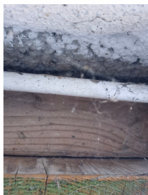
Ingen lufting i nedre del av kledning
