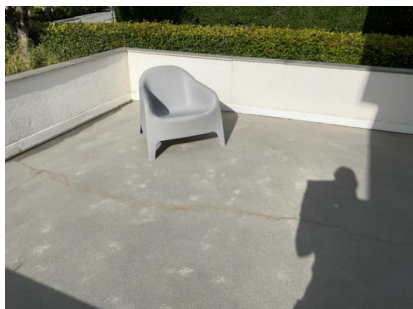
Rekkverk på deler av terrasse er for lavt iht. krav i dagens forskrifter.
