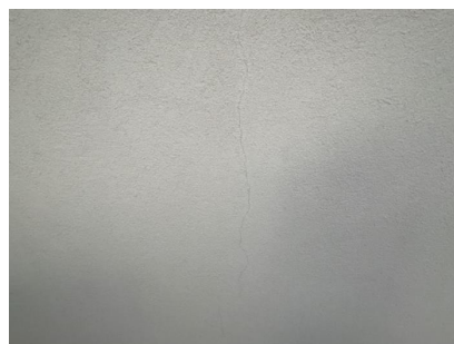
Det er påvist enkelte riss i puss på utvendig murvegg.
