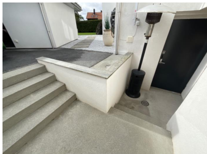
Støttmurer rundt kjellertrapp er ikke sikret med rekkverk.
