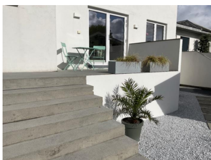
Deler av terrasse er ikke sikret med rekkverk.
