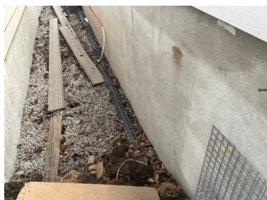
Manglende klemlist på grunnmursplast.
