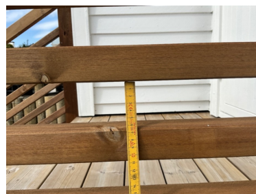
Åpning mellom horisontale spiler målt til 65 mm i trapp til stue.
