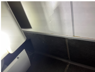
Manglende fugemasse i sokkelprofil til våtromsplater.
