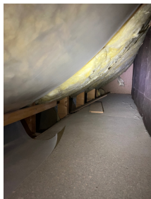
Manglende dampsperre på takkonstruksjon i knekott.
