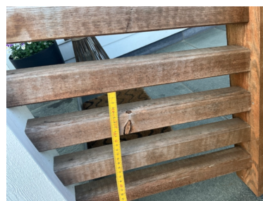
Åpning mellom horisontale spiler målt til 50 mm ved boligens inngangsparti.
