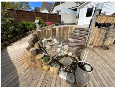
Manglende rekkverk mellom dekorasjon og gangvei
