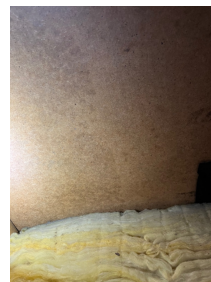
Manglende luftespalte mellom undertak og isolasjon.
