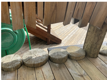
Åpninger i rekkverk til terrasse som er over 10 cm.
