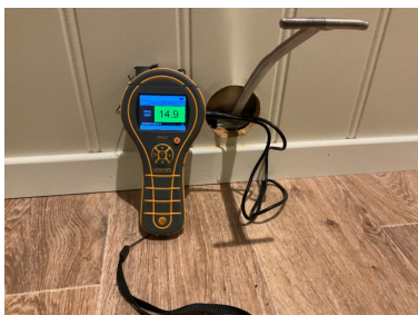
Fuktmåling som viser 14,9 vekt%
