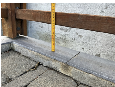
Åpninger i rekkverk til kjellertrapp som er over 10 cm.
