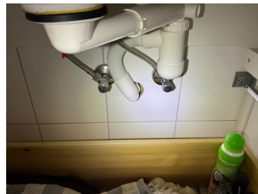
Utett rørgjennomføring under vask.
