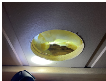
Fuktskjolder i veggens bunnsvill.
