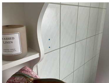
Hull i vegg i dusjens våtsone.
