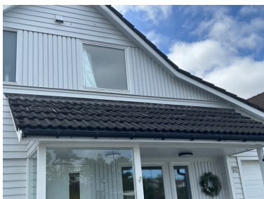
Manglende snøfanger på tak.
