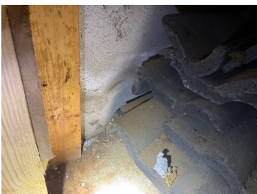
Saltutslag på synlig grunnmur.
