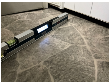
Bildet viser måling av fall på gulv i dusj som er målt til 4 mm/m.
