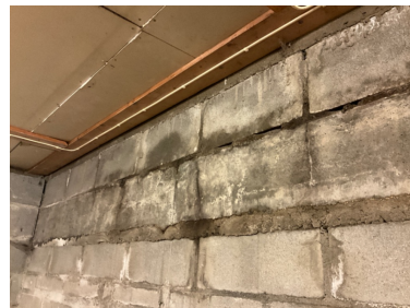
Fuktmerker i overgang tak av tre og betongdekke
