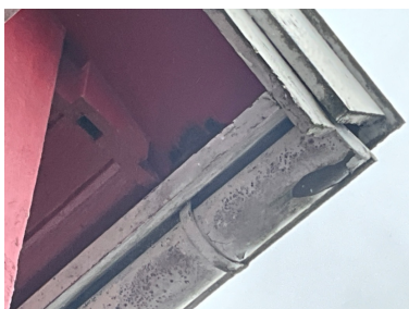
Råteskadet kassbord som følge av lekkasje i tekkingen.
