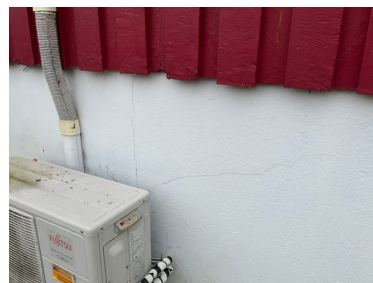
Riss på utvendig grunnmur.
