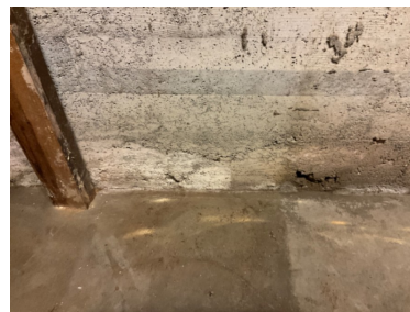
Saltutslag på grunnmur.
