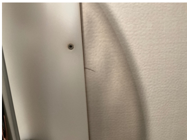
Sprekk i belegget på vegg i dusjens nedslagsfelt.
