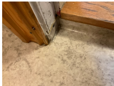
Sprekk i gulvbelegg.
