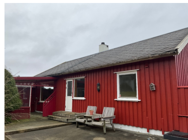
Manglende snøfanger på taket.
