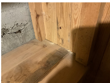
Treverk med spor etter borebill.
