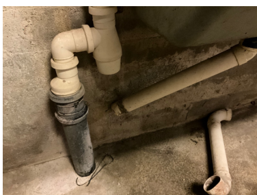
Avløp fra vask som føres direkte ut på gulv.
