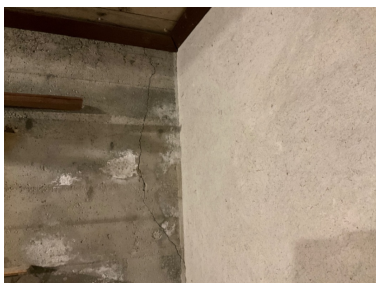
Riss på innvendig grunnmur.
