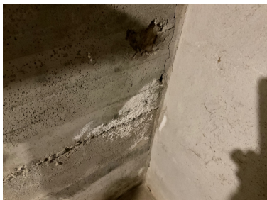
Saltutslag på grunnmur som er under terrenget.
