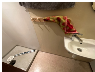
Manglende tettesjikt på vegg i vaskens våtsone.
