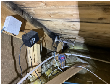
Fuktig takkonstruksjon på grunn av lekkasje.
