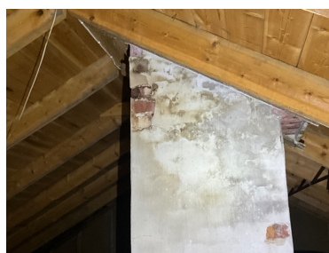
Område med manglende murpuss.
