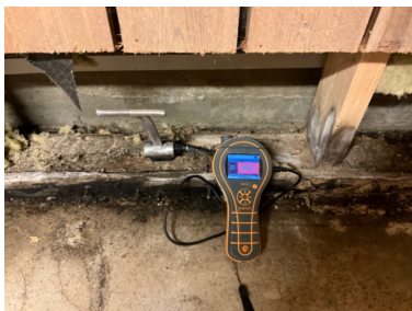
Råteskadet vegg i arbeidsrom.
