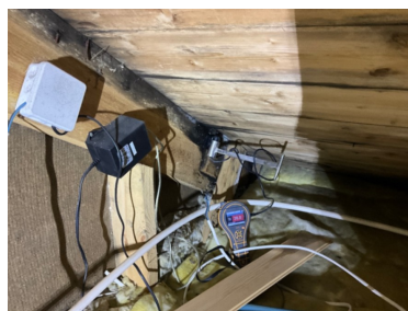
Tegn til lekkasje på kaldloft.
