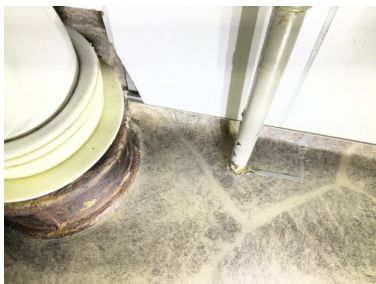
Utettheter i belegg ved rørgjennomføringer i gulv.
