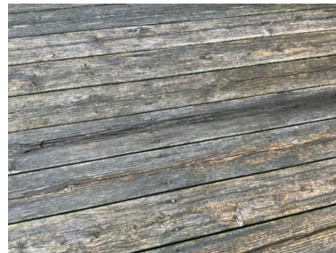
Terrasedekke med spredt råte.
