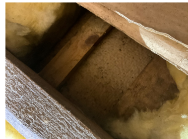
Manglende dampsperre mot oppvarmet rom.
