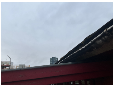
Takrenne med nedbøyninger.
