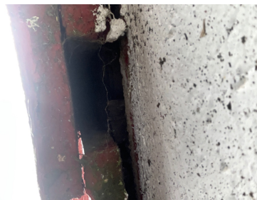
Manglende musesperre mellom kledning og grunnmur.
