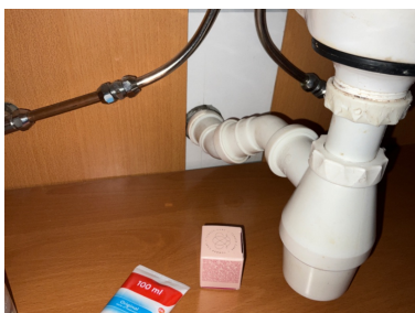
Manglende tetting rundt avløpsrør fra vask.
