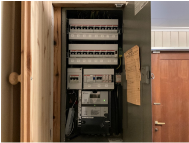
Oversiktspåse av sikringsskap.
