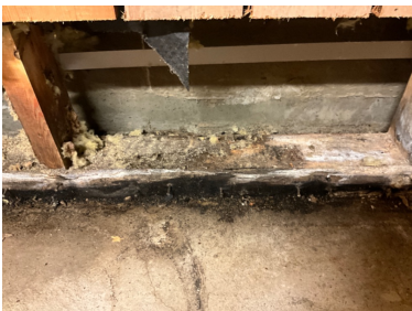
Råteskade i påforet vegg.
