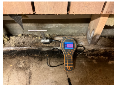
Fuktmåling som viser fullmetning i påforet vegg.
