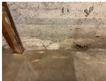
Saltutslag på grunnmur som er under terrenget.
