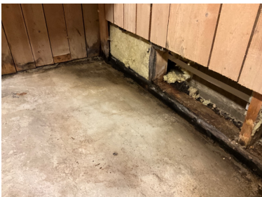
Råteskade i påforet vegg.
