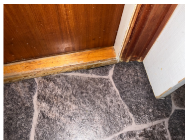
Sprekker i gulvbelegg.
