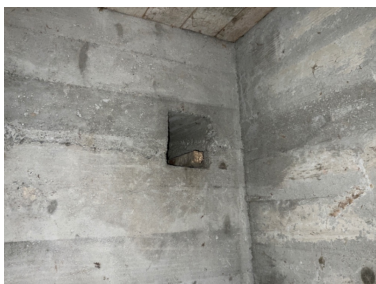
Naturlig ventilering via veggventil.
