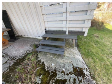
Ikke rekkverk fra balkong.
