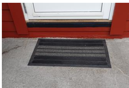
Det er registrert skjevhet på gulvet på veranda i betong
