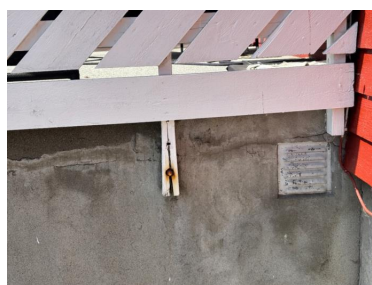
Muren har sprekker
