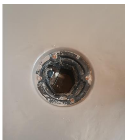
Plastsluk med vinylbelegg tilsluttet med klemring
