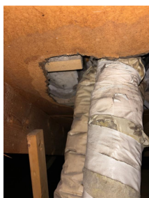
Kanalgjennomføring i taket må utbedres
