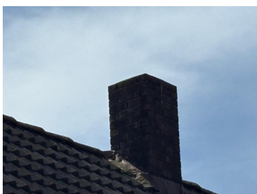
Pipen over tak inkludert beslag er vurdert å være fra byggeår.
