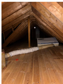
Gulvet på loftet har synlig nedbøying
