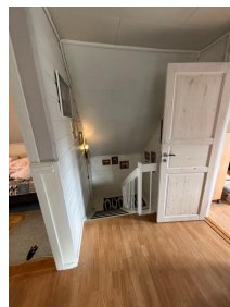
Deler av gulvet som strekker over loftstuen har synlig nedbøying
