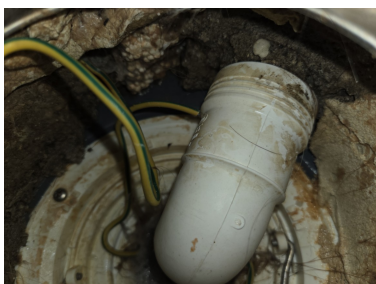
Synlig isopor i sluktrakt
