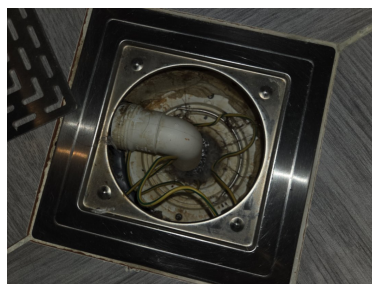
Rørstuss hindrer enkel betjening av vannlås
