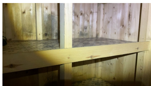
Fuktskader i panel i rom under terrasse
