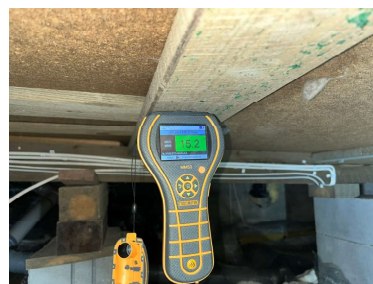
Målte fuktinnhold til 15% i bjelkelag.
