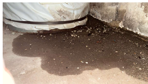
Fuktighet ved varmtvannstank
