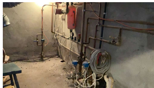
Magnetventiler installert på vannledninger
