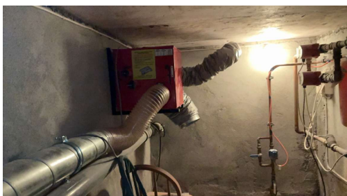
Luftavfukter montert i kjeller under kjøkken
