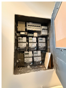
Felles sikringskap i yttergang med automatiske målere.
