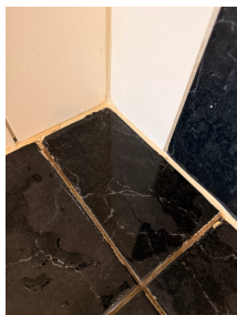
Feil helling på flis i hjørne på dusjen, vann vil bli stående igjen her.
