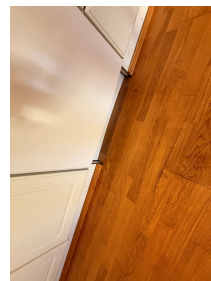
Fuktpreget gulv ved vask/oppvaskmaskin.
