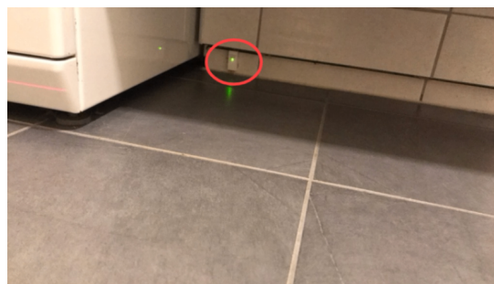
Bilde viser magnetventil.
