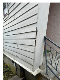
Vannbord mot grunnmur. Råteskadet hjørnebord.
