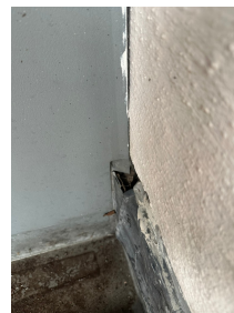
Mangelfull blyteking mot yttervegg.
