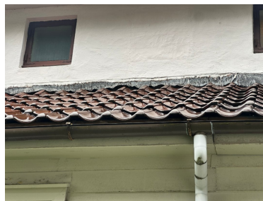
Ujevn blytekkning mot teglstein.
