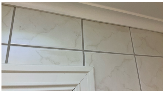
Riss i flisefuger over dør.
