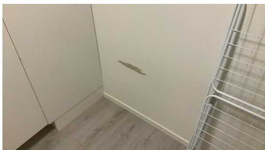
Slitasje/merke på vegg.
