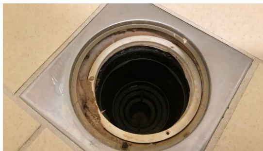
Sluk i gulv.
