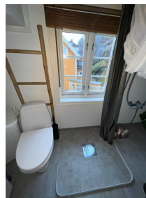
Vindu på bad. Alternativ rømningsvei må utbedres.
