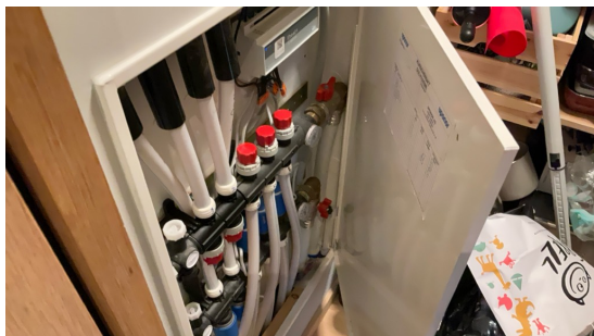
Skap 2 for vannbåren gulvvarme.
