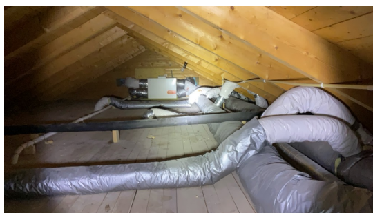
Ventilasjonsanlegg/rør sett på loft.
