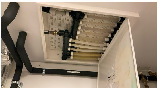
Vannfordelerskap i tak.
