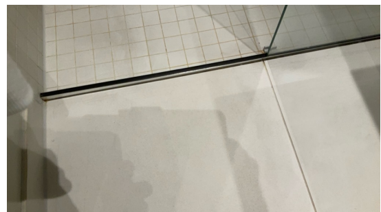
Bl.a området med bom/hullyd under.
