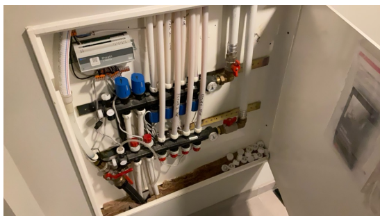
Skap 1 for vannbåren gulvvarme.
