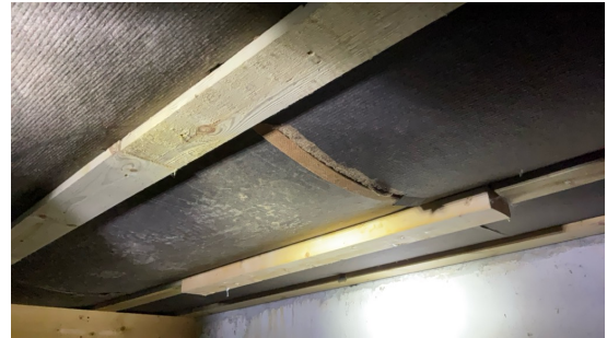
Åpninger/gliper mellom tversskjøter på underkledning/vindtetting i bjelkelag.
