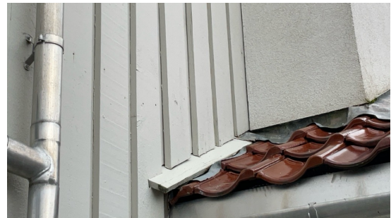
Værslitasjer/oppspricking på nedre del av bordkledning over panner.
