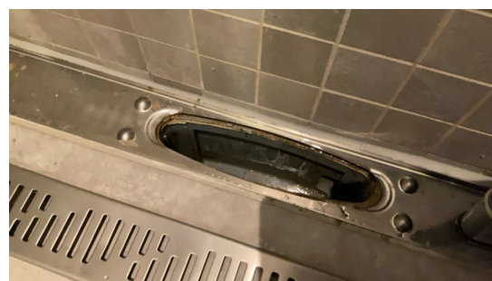
Slukrenne i dusj.
