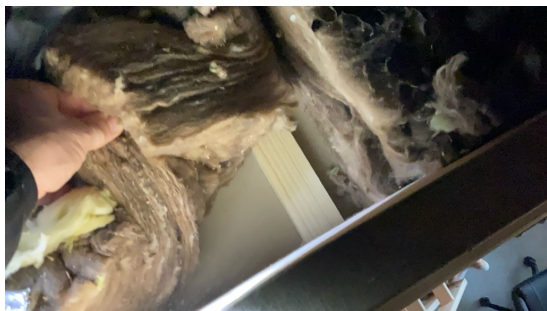
Ikke brukt plast/diffusjonssperre tilfeldig valgt sted.
