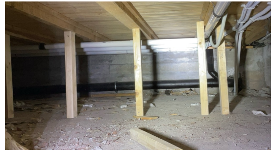
Mer eller mindre provisoriske oppstøttinger av bjelkelaget sett i krypkjellere.
