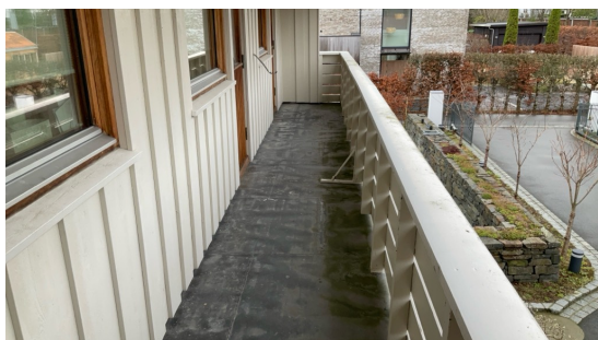
Skjevt rekkverk på balkong.
