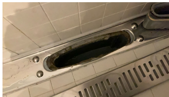
Slukrenne i gulv/dusj.
