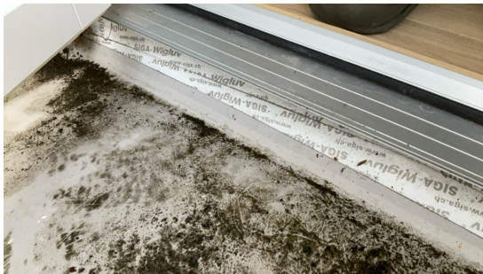
Uferdig/ufagmessig utførelse under terskel på balkongdør.
