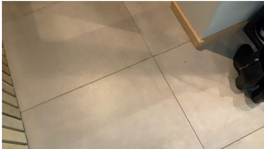
Sprikk i flisefuge, bom/hullyd under enkelte fliser.
