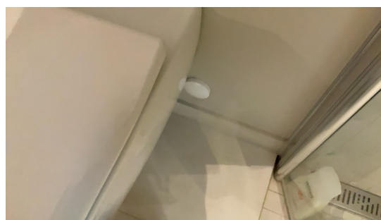
Drengåpning fra sisternen på toalettassen.
