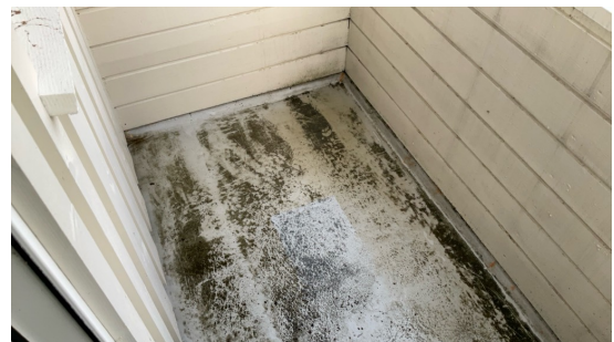
Vannansamling på balkong mot sjø.
