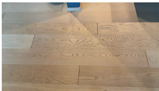
Åpninger i tverrskjøter parkett.
