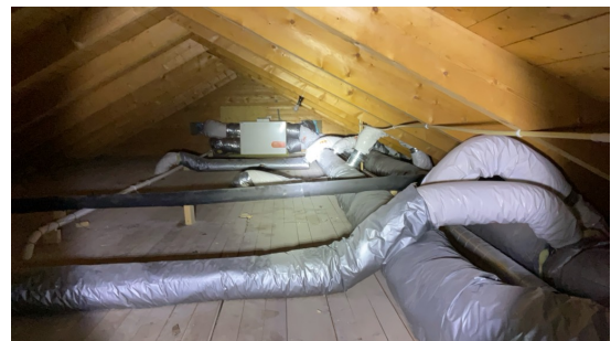
Ventilasjonsanlegg/rør sett på loft.
