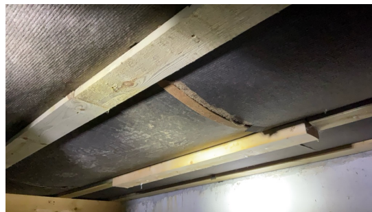
Åpninger/gliper mellom tversskjøter på underkleddning/vindtetting i bjelkelag.
