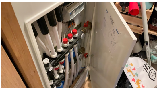
Skap 2 for vannbåren gulvvarme.
