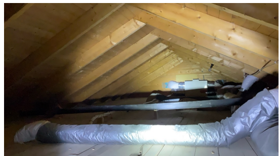
Saltak av sperr fra ca 1954.
