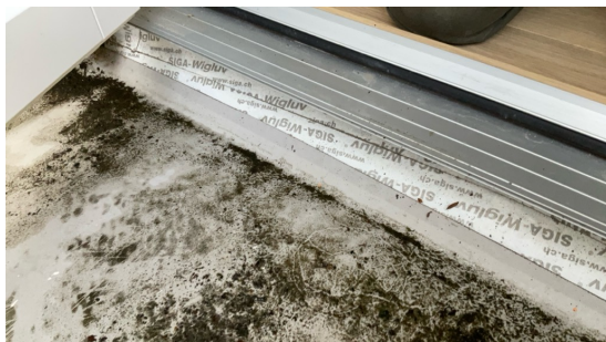
Uferdig/ufagmessig utførelse under terskel på balkongdør.
