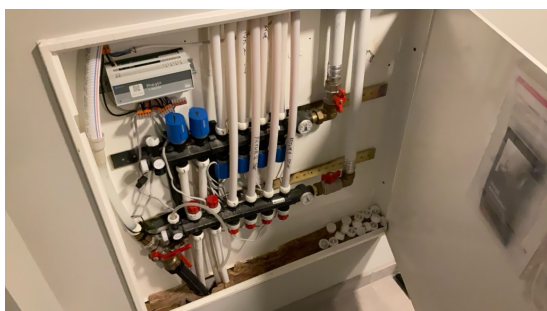
Skap 1 for vannbåren gulvvarme.
