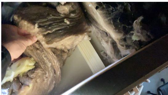
Ikke brukt plast/diffusjonssperre tilfeldig valgt sted.
