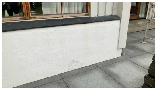
Avflassing på mur ute.
