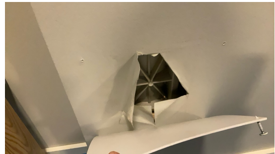
Stakemulighet på avløpsanlegget
