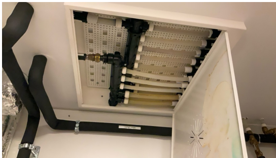
Vannforderskap i tak.
