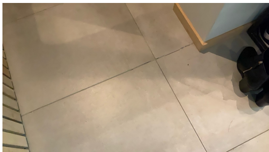
Sprikk i flisefuge, bom/hullyd under enkelte fliser.
