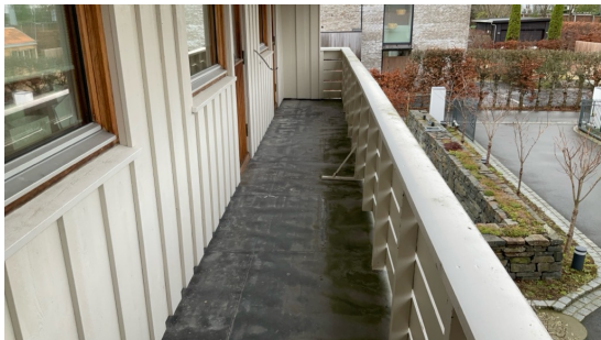
Skjett rekkverk på balkong.
