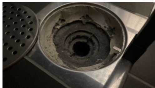
Sluk i vaskerom.
