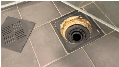
Sluk i dusjsone.
