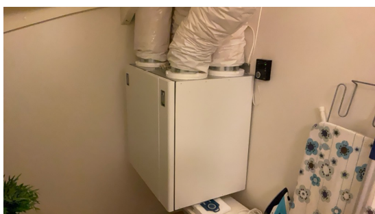
Motor for ventilasjonsanlegget.
