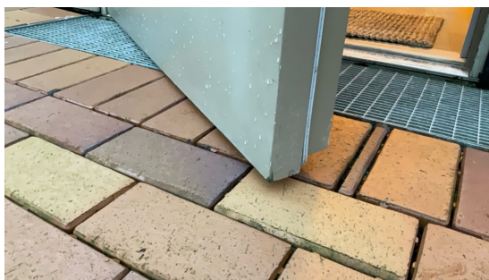
Mindre skade/fuktsvelling i nedre kant dørblad.
