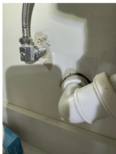
Bildet viser at det ikke er etablert tettesjikt i våtsonen rundt servant.
