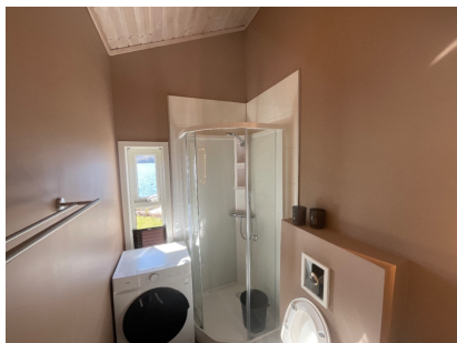
Bildet viser at det ikke er etablert tettesjikt i hele våtsonen rundt dusj.
