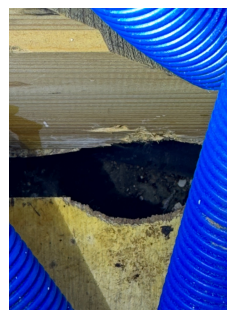
ildet viser stedet hvor det ble observert noen ekskrementer i gulvkonstruksjonen (lite synlig på bildet).
