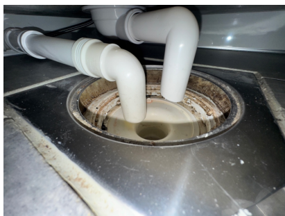
Bildet viser at tettesjikt synes å ha en tett forbindelse til sluk, klemt inn under klemring. Det ser ut til at det er tettesjikt av vinylbelegg som er klemt i klemring, og som senere er smurt med smøremembran
