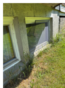
Kjellervinduer står nær terreng
