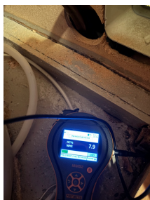
Fuktmåling i veggen mellom bad og rom med bereder i i hoveddelen viser ingen unormale verdier
