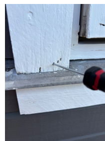
Det er begynnende råte i belistning/kledning
