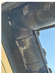
Det er tegn til lekkasje i takrenner
