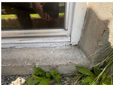
Kjellervindu har råteskade
