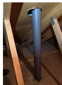
Huller for rørføringer har for store åpninger
