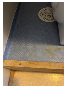
Sluk i oppbygd gulv på vaskerom
