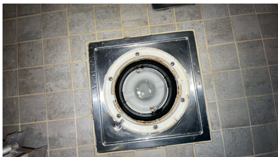
Bilde viser sluk. U.ETG. > BAD
