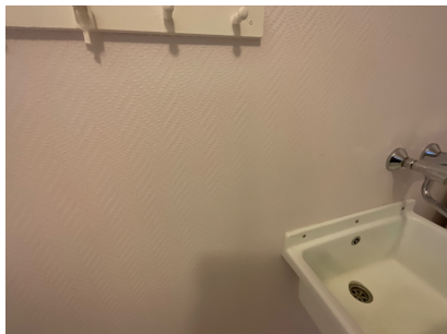
Bildet viser malt tapet på vegg i våtsonen.
