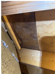
Bildet viser at det er vått i sutaksplate rundt pipe.
