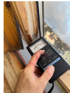
Bildet viser kondensmerker i takvindu, men tørt ved fuktsøk på befaringsdagen.
