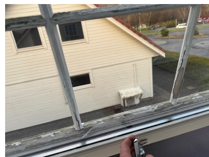
Bildet viser værslitte utpåliggende sprosser på vinduer i 2.etg.
