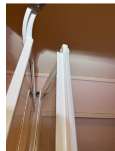
Bildet viser manglende feste øverst på dusjdør.
