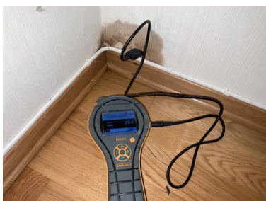
26,4% fukt i soverom
