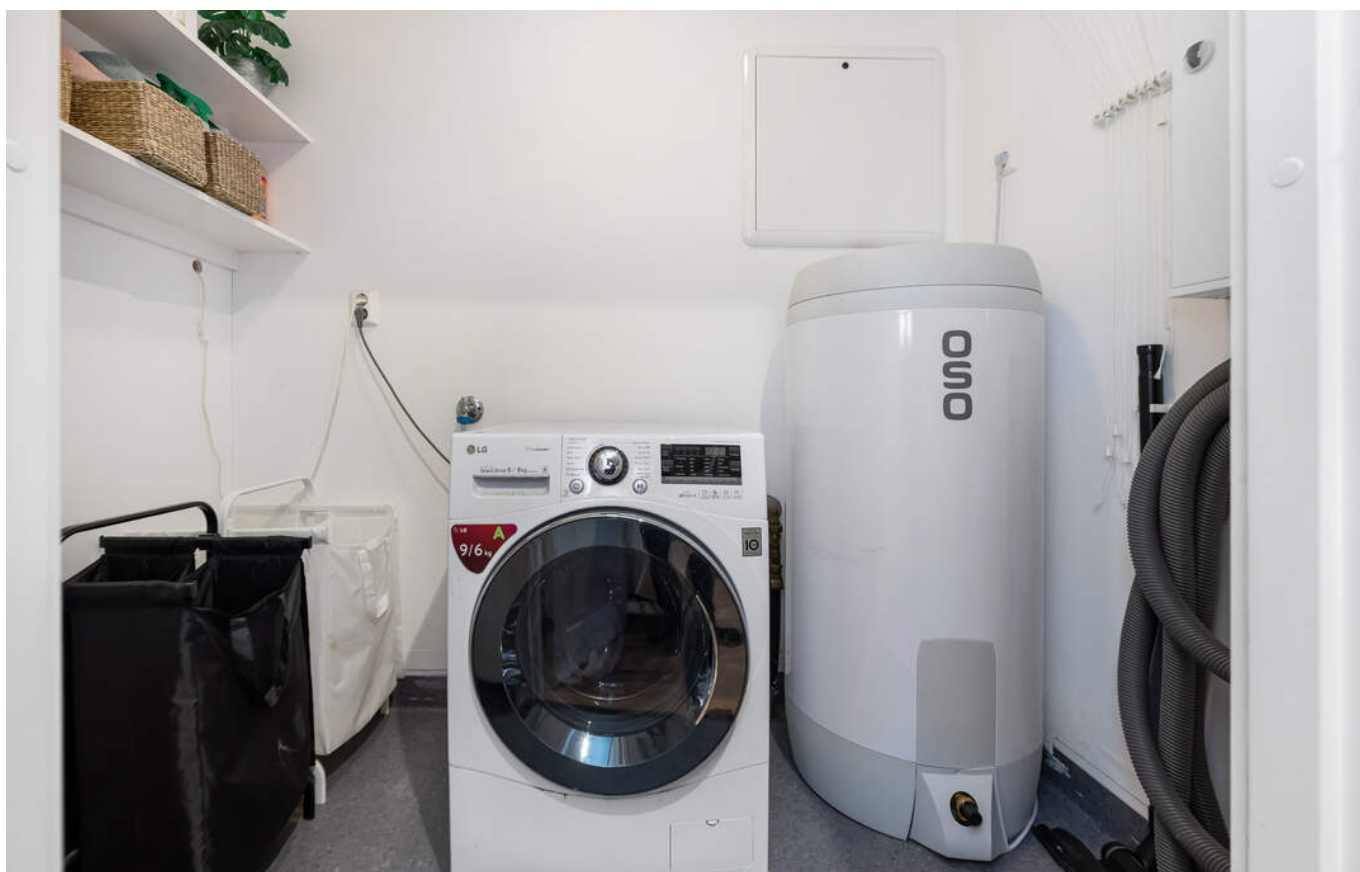
Eget vaskerom. En slipper å ha vaskemaskin og varmtvannstank på badet.
