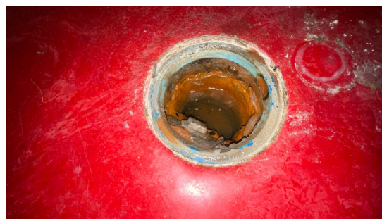
Gulvbelegg klemt ned i eldre stålsluk.
