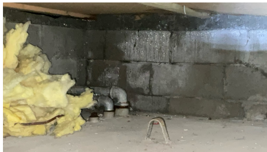
Det er fukt/kondens over oljetank rundt rør og på grunnmur samt noe i takplater.
