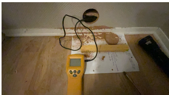
Hulltaking er utført i vegg fra gang bak blandedbatteri vask og helt tørt.
