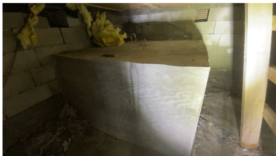
Oljetank innfelt i grunnmur/ fundament
