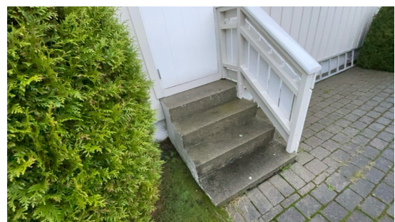
Mangler rekkverk på en side bi-inngang.
