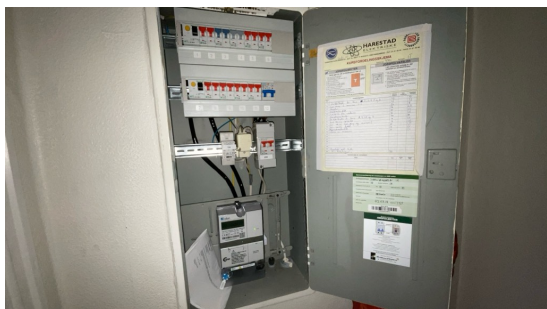
Automatsikringer i el skap fra 2005.
