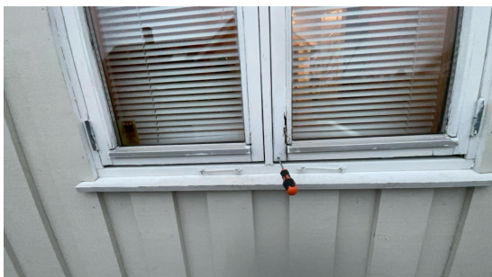
Det er råte i vindu i bod sett fra terrasse.
