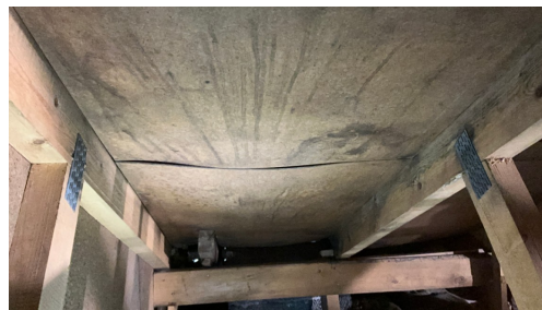
Det er misfarging i undertaket ved pipegjennomføring,
