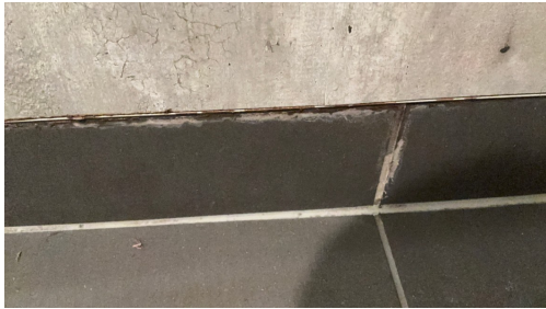
Platene viser tegn til slitasje i nedre kant mot alulist og sokkelflis.
