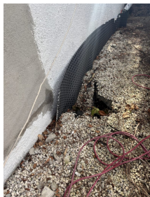
Det er ikke montert topplist på grunnmursplast
