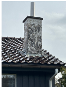
Pipen viser tegn til slitasje på utvendig overflate og beslag
