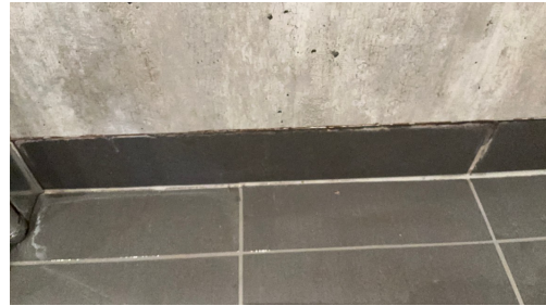
Platene viser tegn til slitasje i nedre kant mot alulist og sokkelflis.
