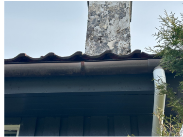
Pipen viser tegn til slitasje på utvendig overflate og beslag
