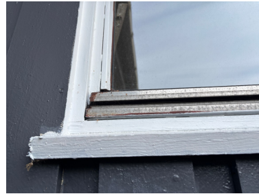
Vinduer har slitasje
