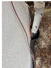
Det er ikke montert topplist på grunnmursplast, nedløpsrør er lagt på feil side av grunnmursplast
