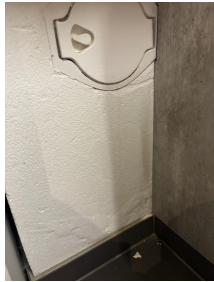
Pipen har tegn til saltutslag i overflaten ved kjellergulvet
