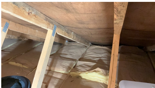
Det er misfarging i undertaket
