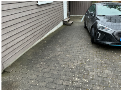
Fall langs bolig ned mot aco renne, renne må holdes under oppsyn.
