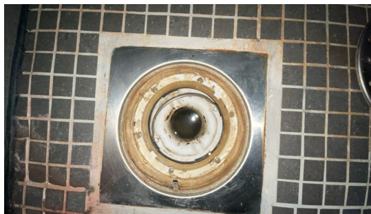
Bilde viser sluk.
