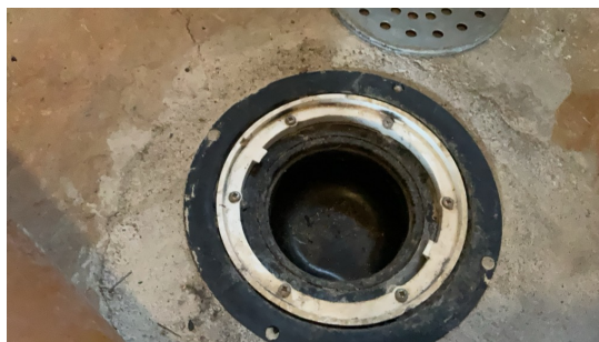
Sluk etablert i teknisk rom med fyrkjele som også har varmtvannstank.
