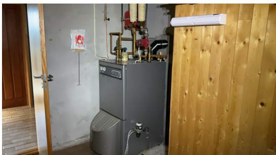
Fyrkjele leverer opp til 9kW varme via radiatorene.
