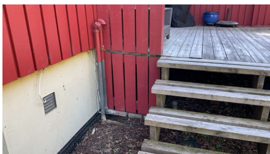
Rørene til oljetank, den er plassert under terrassen.
