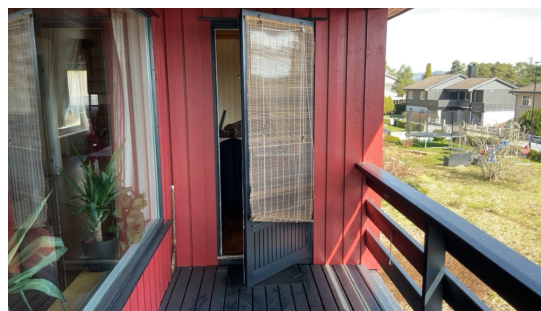
Verandadør mot øst til veranda over inngang. Det er observert punktert glass i dør.
