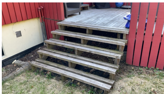
Trapp fra terrasse til hage. Se siste punkt rundt HMS for manglende rekkverk.
