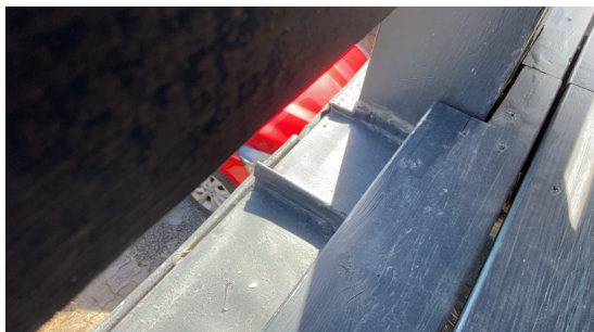
Veranda mot øst har montert blikk under terrassebord slik at det blir tett overbygg over inngang.
