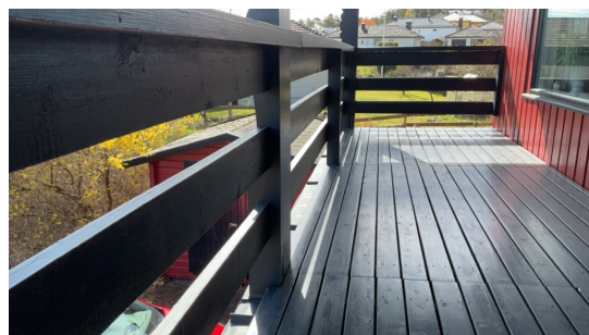
Store åpninger i rekkverk og høyde ned på over 2 meter.
