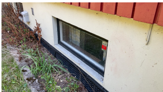
Kjellervindu, et er observert noen sprekker i puss rundt vinduene
