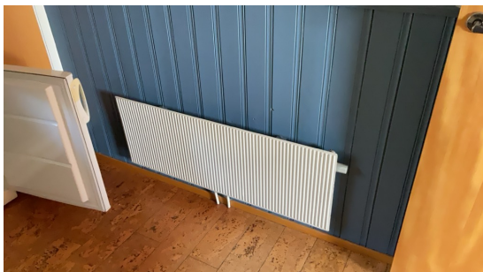
Radiator i alle soverom og kjøkken samt hall.
