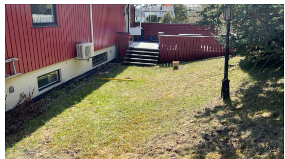
Fallende terreng inn mot grunnmur
