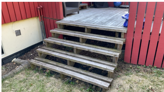
Trapp mangler rekkverk
