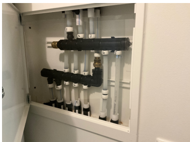
Oversiktsbilde av rørskap,
