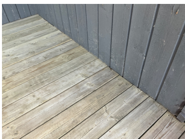
Terrassebord som er plassert helt inntil husvegg.
