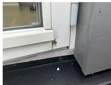
Værslitt dørblad i nedre kant.
