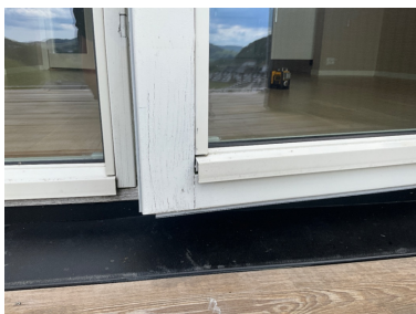
Værslitt dørblad i nedre kant.
