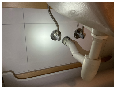
Rørgjennomføring i vegg som ikke er tettet.
