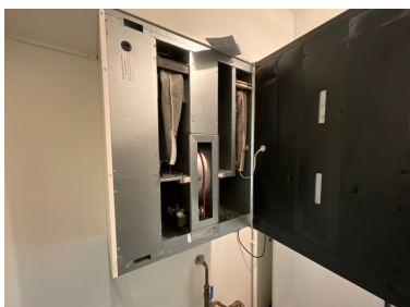
Oversiktsbilde av ventilasjonsaggregat
