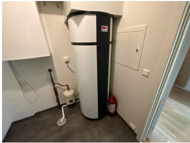
Oversiktsbilde av bereder.
