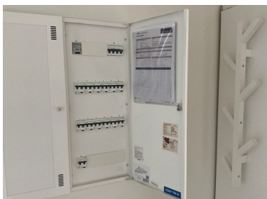
Oversiktsbilde av sikringskap.
