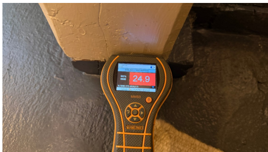
Bilde viser forhøyet fukt i tresøyle i uinnredet rom / grovkjeller.
