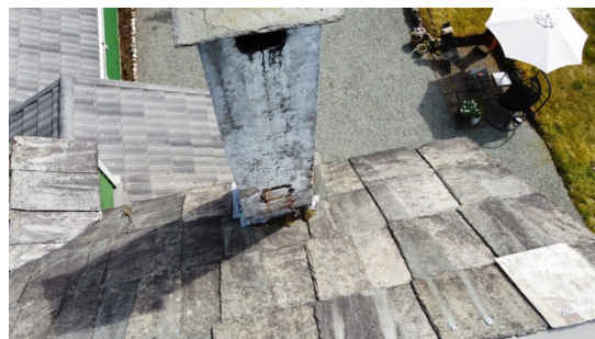
Bilde viser pipe/skorstein. Her har det nylig vært utbedret en lekkasje.
