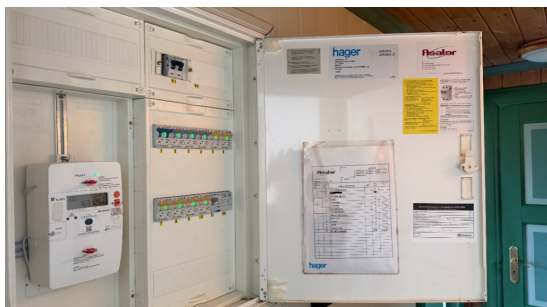
Bildet viser sikringskapet for det elektriske anlegget.
