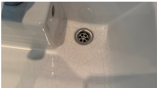
Bilde viser riss i servanten.
