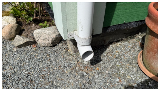
Bilde viser eksempel på at taknedløp er avsluttet over bakkenivå og ikke ledes videre bort fra boligen/fundament.
