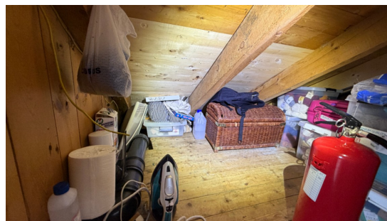
Bilde viser kneloft/kott. Her ser man at deler av sutaket (undertaket) er skiftet ut.
