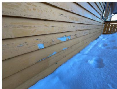
Ikke tilstrekkelig avstand mellom kledning og terrasse, .
