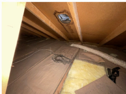
Hull i undertaket og fukt i isolasjonen under.
