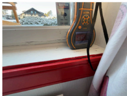
Fukt utslag ved måling i karm og vindu.
