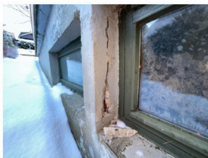
Sprekk og eksponert armeringsjern.
