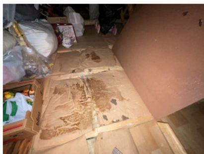
Kondens/fukt mellom laminat og isolasjon.
