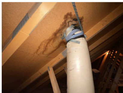
Fukt merker rundt rørgjennomføring.
